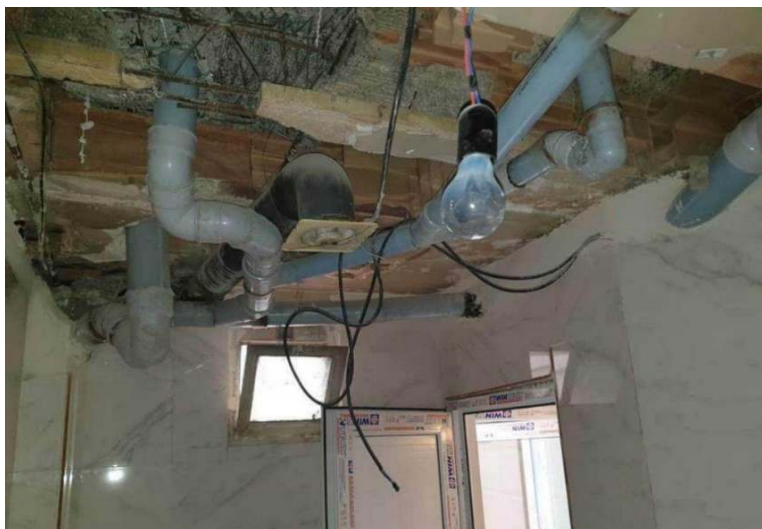
تامین غیر اصولی روشنایی موقت کارگاه ساختمانی توسط لامپ
