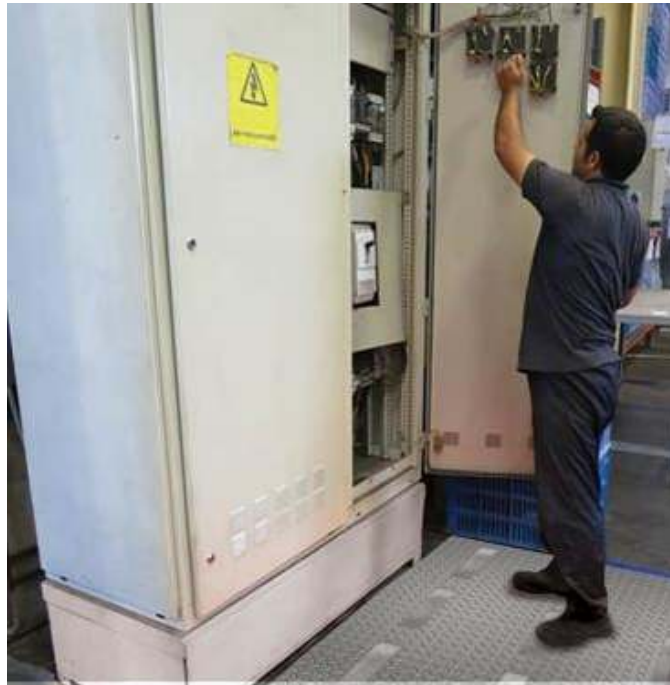
درپوش قفل دار تابلو برق و کف پوش عایق
